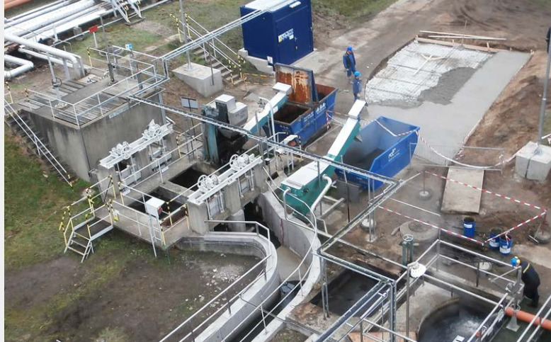
▲ Mechanické předčištění (strojní česle, vírový lapák, separátor písku)
