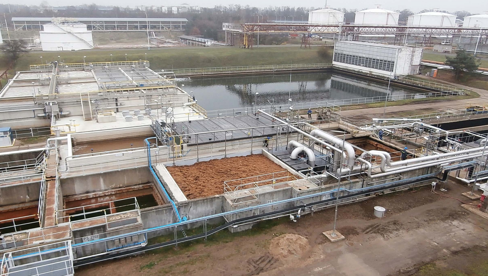
▲ Celkový pohled na ČOV Česká rafinérská, a.s., po rekonstrukci
