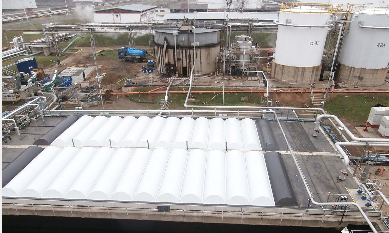
▲ Primární sedimentace po rekonstrukci
