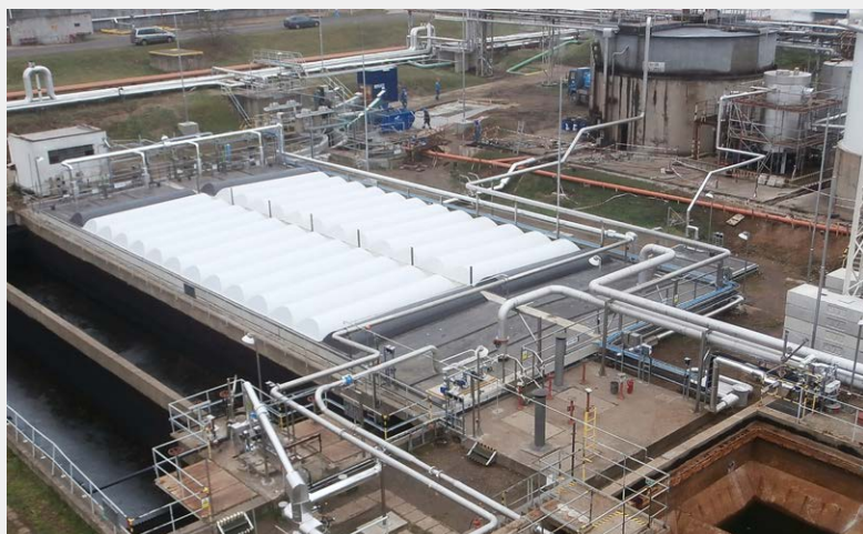
▲ První stupeň – primární sedimentace (zastropené usazovací nádrže s odtahem vzdušiny)
